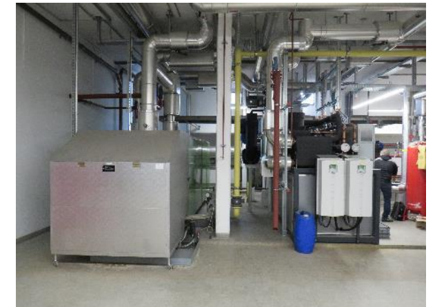
Potenzialanalysen für Wärmerückgewinnung
